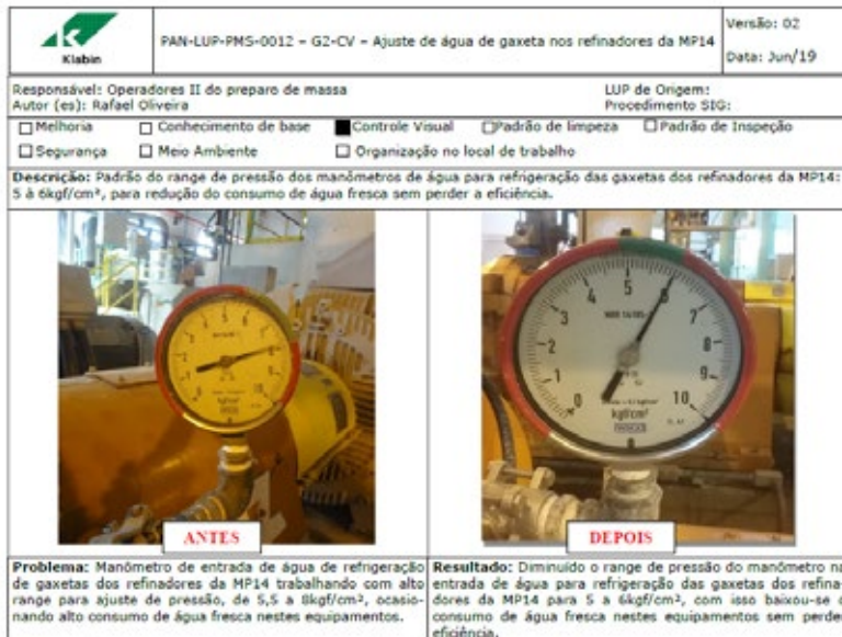
Figura 7: Lição de um ponto – LUP, ajuste de pressão de água de lubrificação
